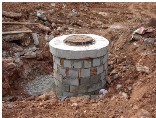
Poço de visita – elemento notável de projeto de esgoto
