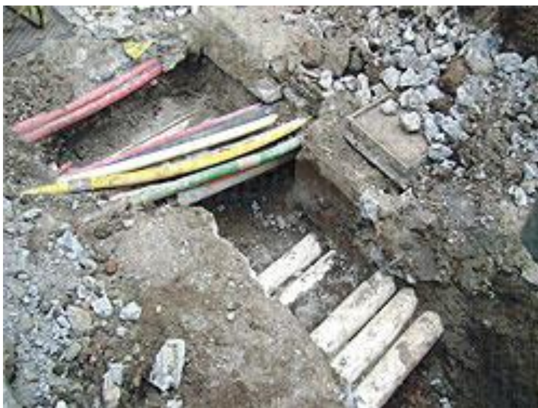
Figura 4: Subsolo congestionado; fonte: revista Técnica edição 140, Nov. 2008
